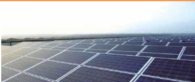
图表34 公司宿迁屋顶光伏发电项目
